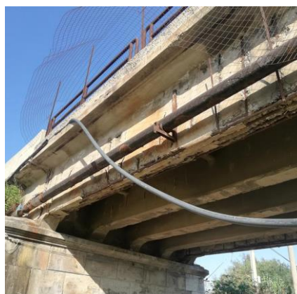
Figura 4 - Ponte Fiumarella Pellaro (RC), Calabria - Impalcato ammalorato.
